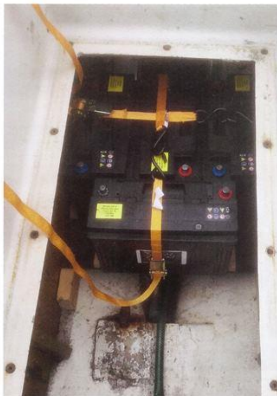
Batterierne forsvarligt fastgjort til plade over aksel.
