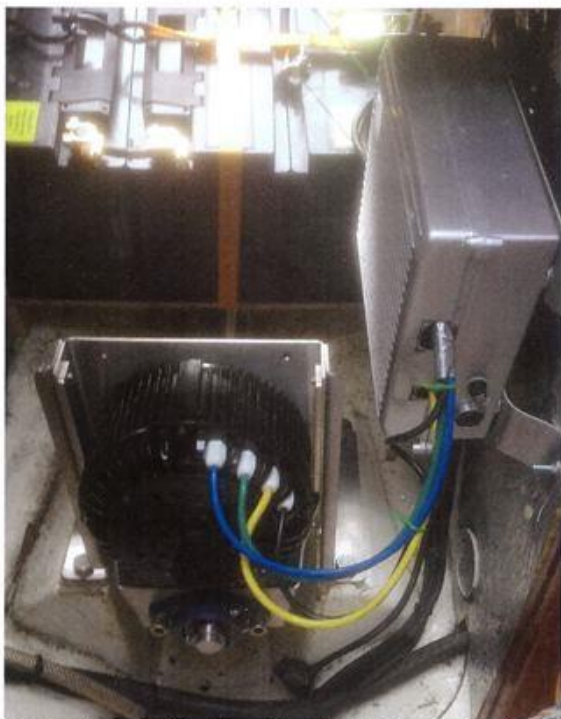
Færdigmonteret motor. Styreboksen til højre i billedet, hvor regulator tilkobles, når den skal bruges.
