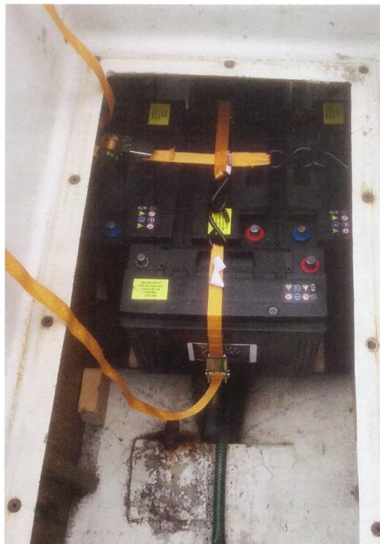
Batterierne forsvarligt fastgjort til plade over aksel.
